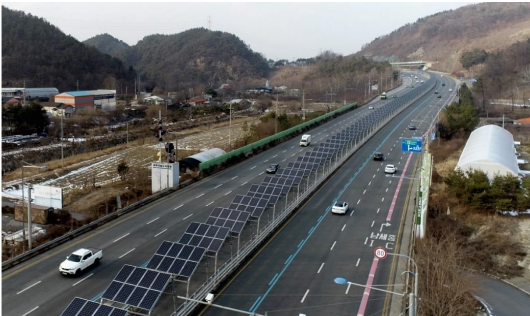
Kuva 10. Aurinkopaneeleita moottoritien päällä. (South Korea's Ministry of Land, Infrastructure and Transport, 2022)
