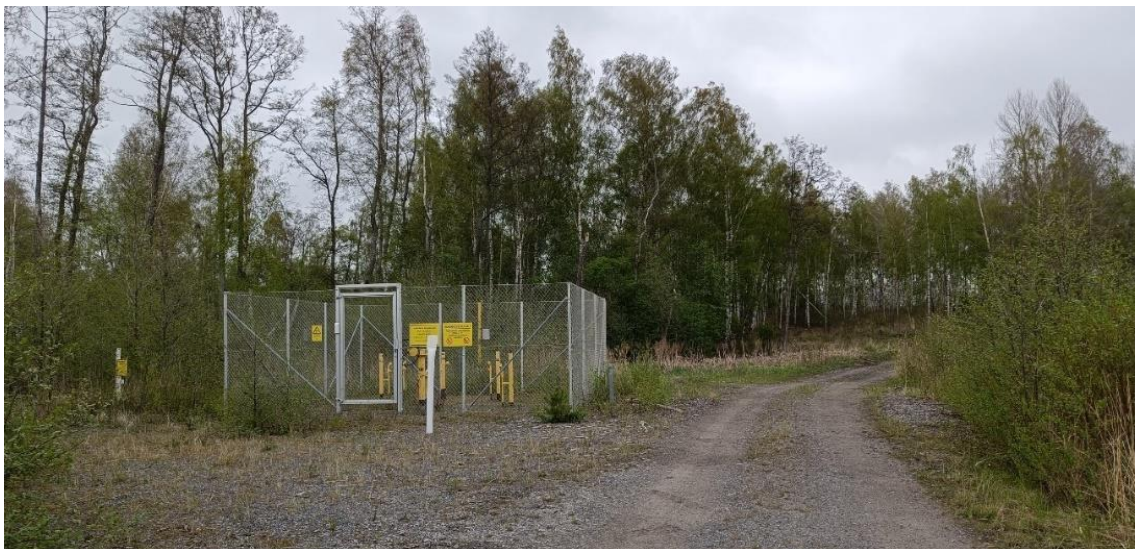
Kuva 22. Kaava-alueella sijaitseva maakaasun venttiiliasema.
