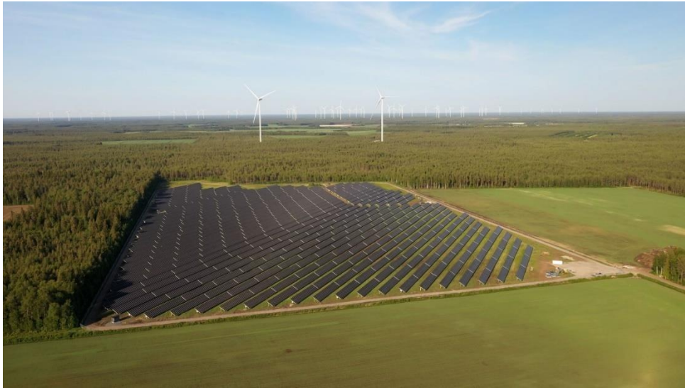
Kuva 11. Kalajoen Juurakon aurinkovoimala. (Solarigo Systems Oy, 2023)
