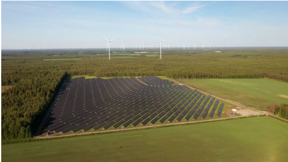
Kuva 11. Kalajoen Juurakon aurinkovoimala. (Solarigo Systems Oy, 2023)
