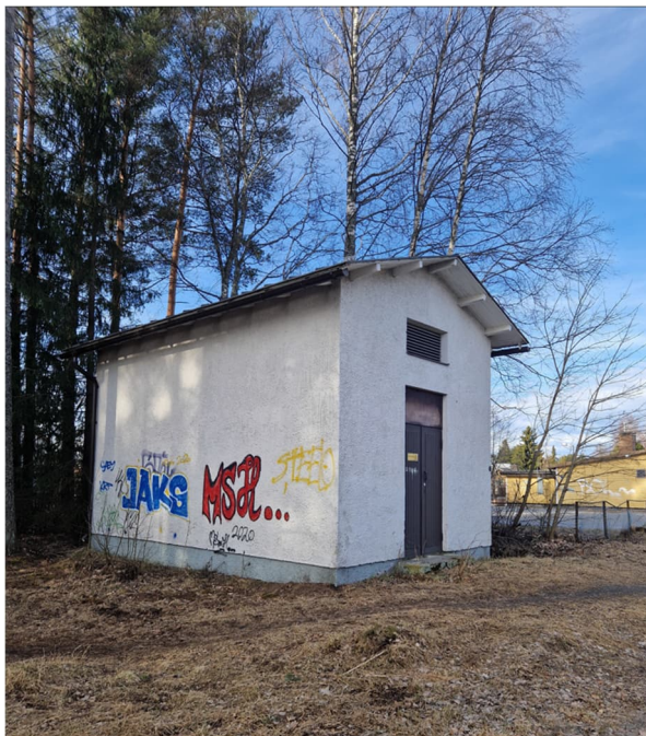
Kuva 6 Kuva suunnittelualueen pohjoisosan puistomuuntamosta. (kuva: Tia Koponen 2.4.2025)
