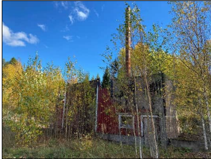
Palanut kuivaamorakennus suunnittelualueen kiinteistöllä 413-408-6-49 KALLIO.
