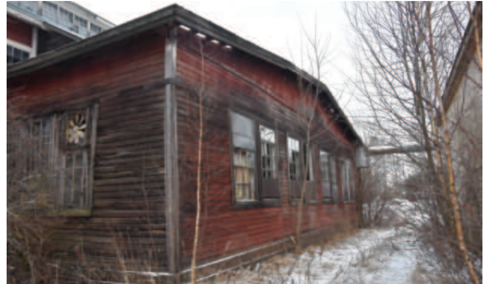
1950-luvun laajennussiipi, jonka katto on romahtanut.
