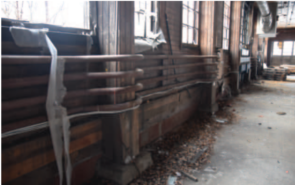
Ulkoseiniä kiertää lämmitysputket.
