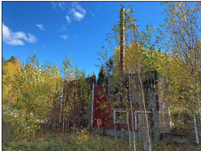
Palanut kuivaamorakennus suunnittelualueen kiinteistöllä 413-408-6-49 KALLIO.
