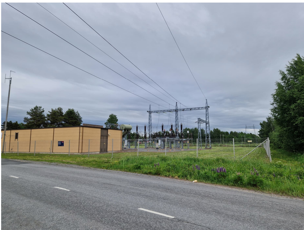
Kuva 1 Sähköasema kuvattuna luoteesta. (© Tia Koponen, 6.6.2024)
