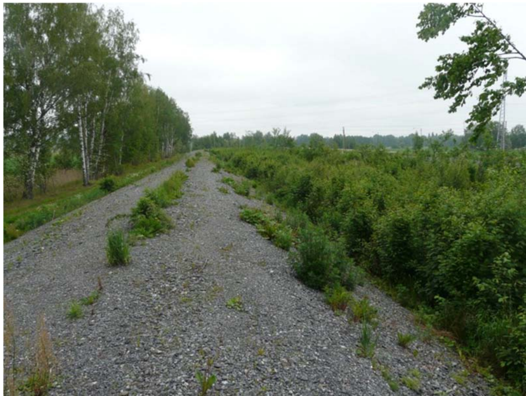
Kuva 5. Hyvelän peltoalueen ja valtatie 8 välistä pengertä. Oikealla penkereen ja leveän ojakaivannon välistä pensain- ja taimikkoaluetta.
