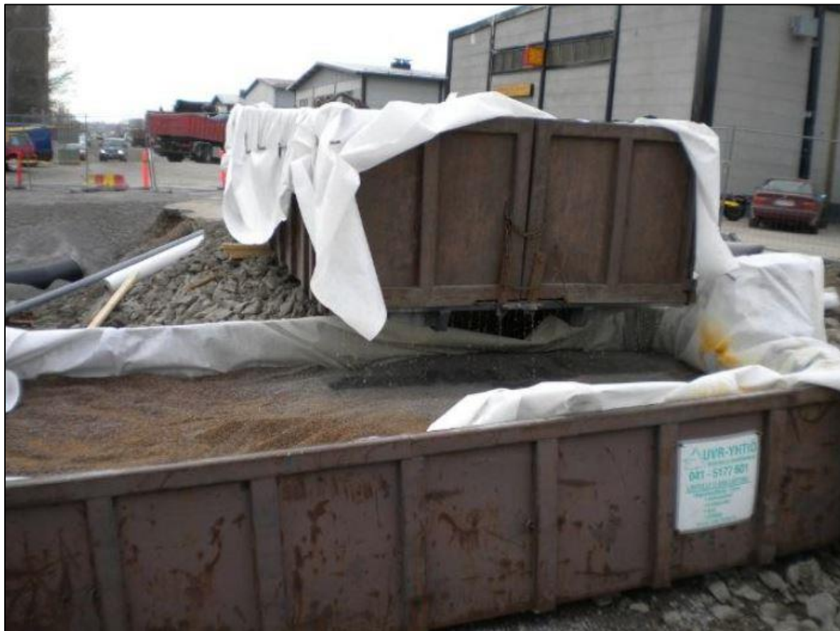
Kuva 11. Esimerkkikuva vaihtolavan sisään rakennetusta suodattimesta. 3
