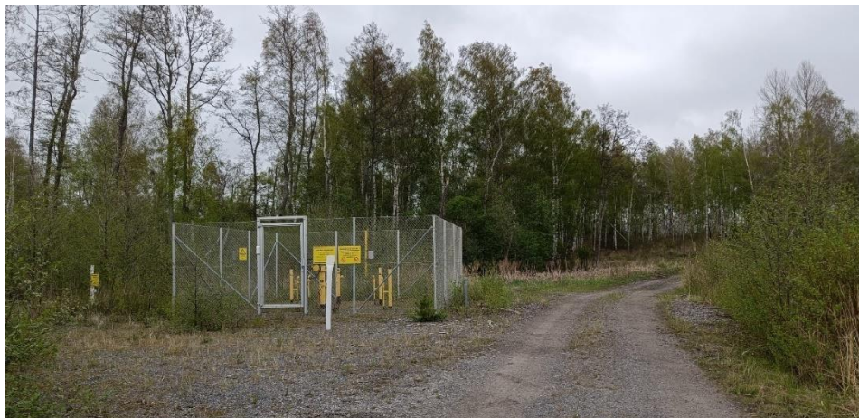
Kuva 13. Kaava-alueella sijaitseva maakaasun venttiiliasema. Taustalla näkyy kaksi tuulivoimalaa.
