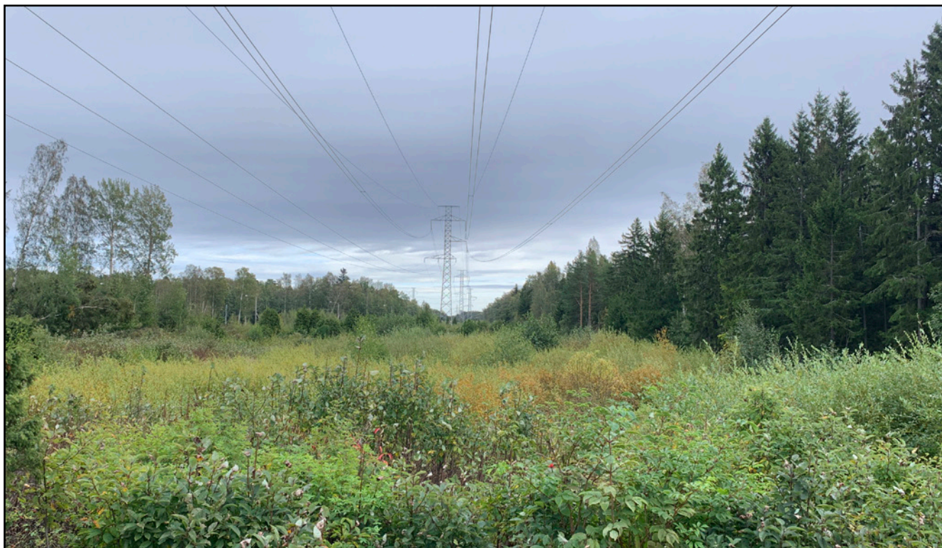
Tyypillistä joutomaakasvillisuutta sähkölinjalla.
