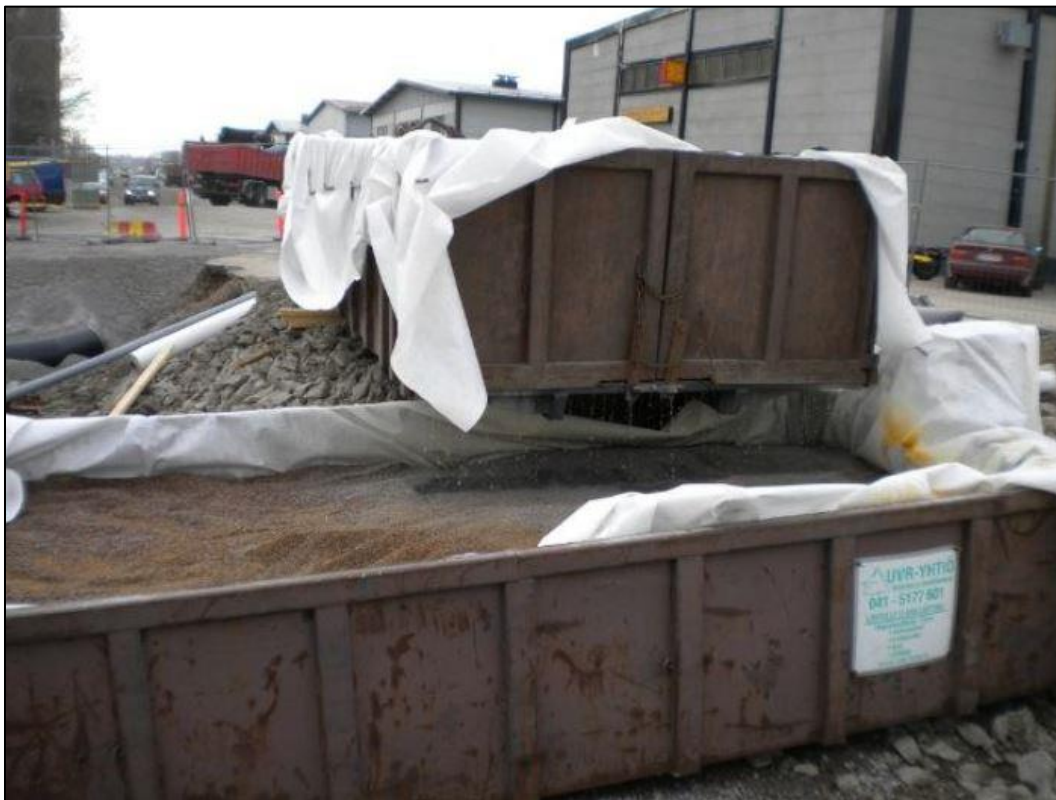
Kuva 11. Esimerkkikuva vaihtolavan sisään rakennetusta suodattimesta. 2
