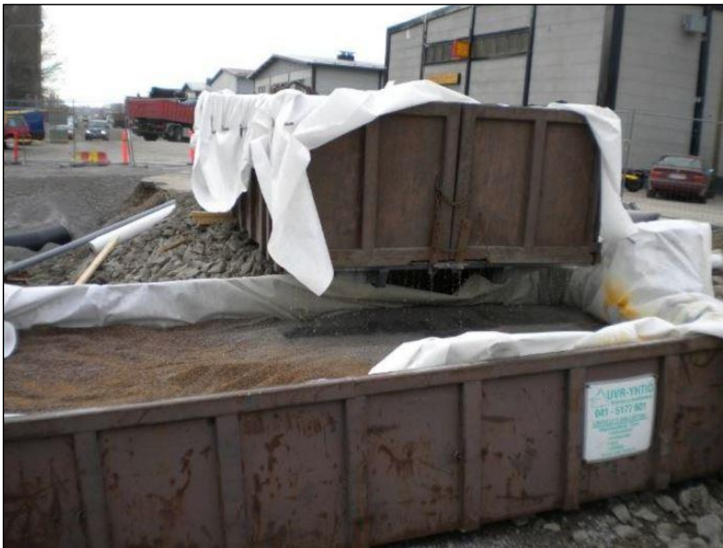
Kuva 11. Esimerkkikuva vaihtolavan sisään rakennetusta suodattimesta. 2
