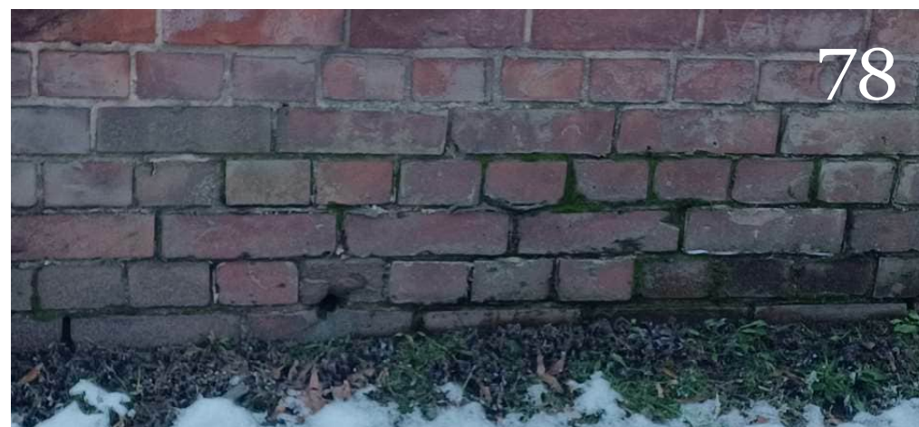
Kuva 78. Läntisen julkisivun pohjoispäädyssä maa on kohonnut tien uusimisen myötä niin, ettei kivijalka näy.
