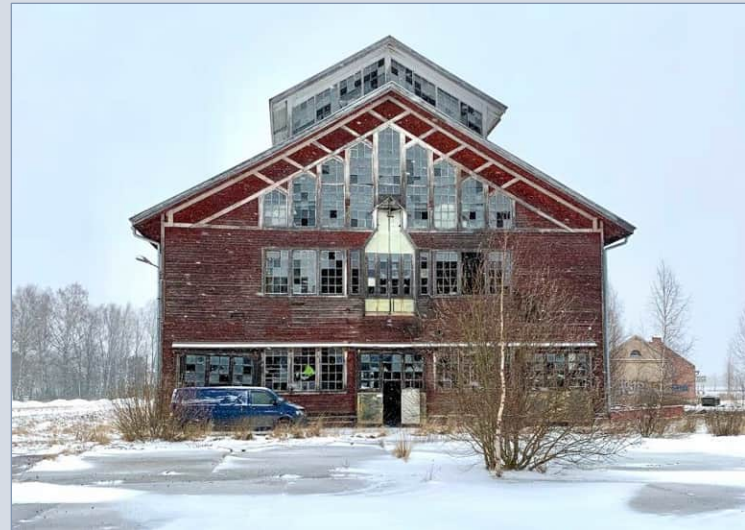
Sahan vuosituhanen vaihteessa kunnostettujen ikkunoiden ruudut on osittain rikottu.
