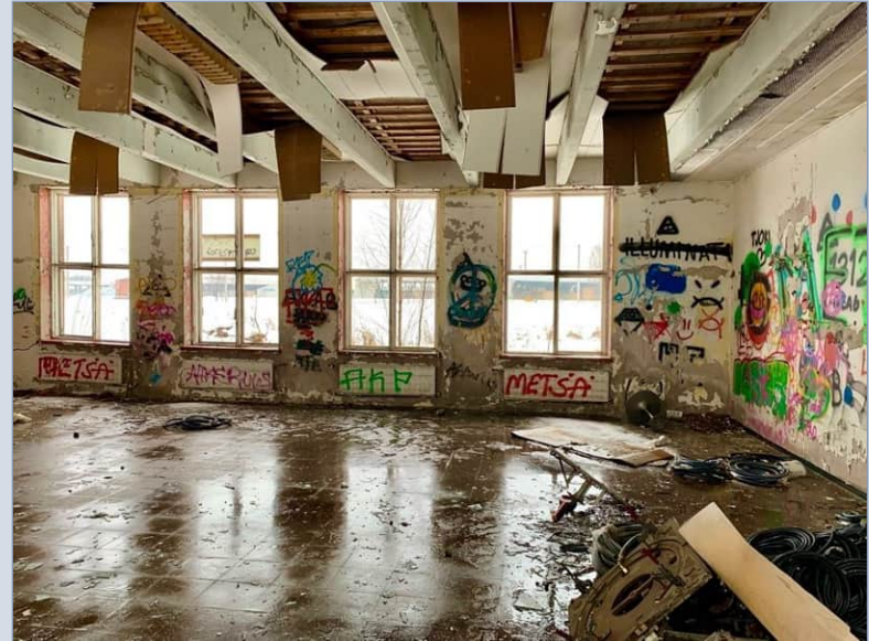
Voima-aseman sisätilat ovat kärsineet ilkeivallasta.
