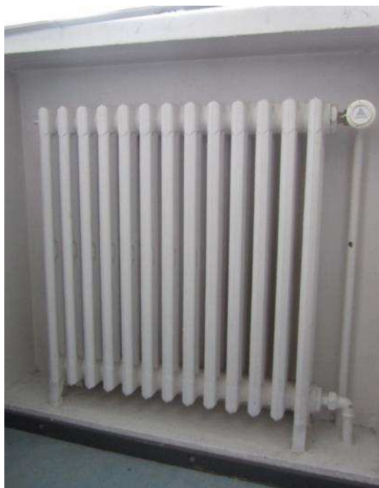
Alkuperäiset pylväsradiaattorit ovat säilyneet muutamissa huoneissa.
