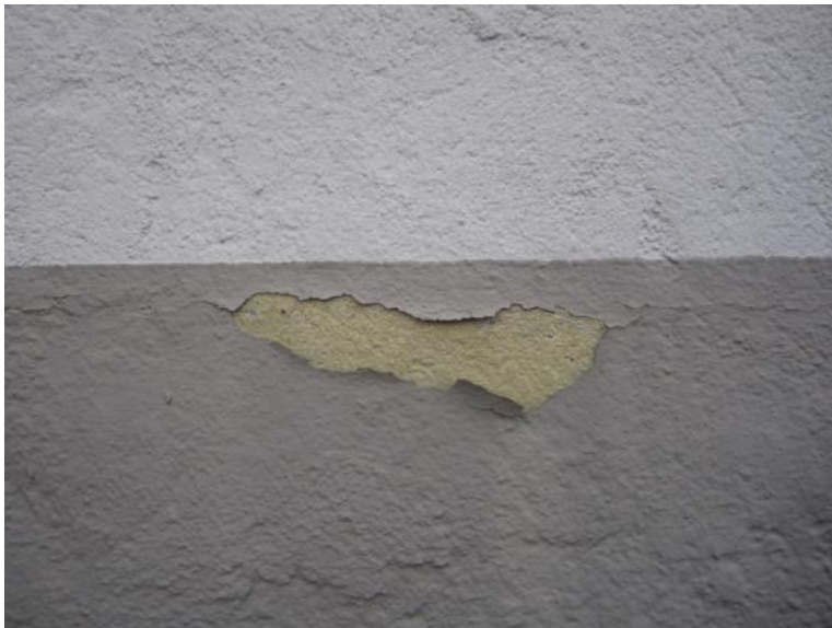
Nykyisen maalikerroksen alta pilkistää keltaista maalia.
