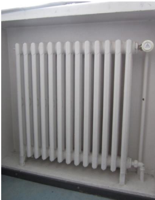
Alkuperäiset pylväsradiaattorit ovat säilyneet muutamissa huoneissa.
